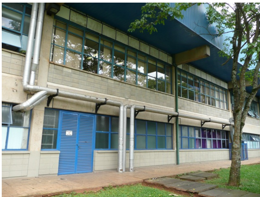
Figura 4.2 – Dutos de água gelada – Chiller 1
